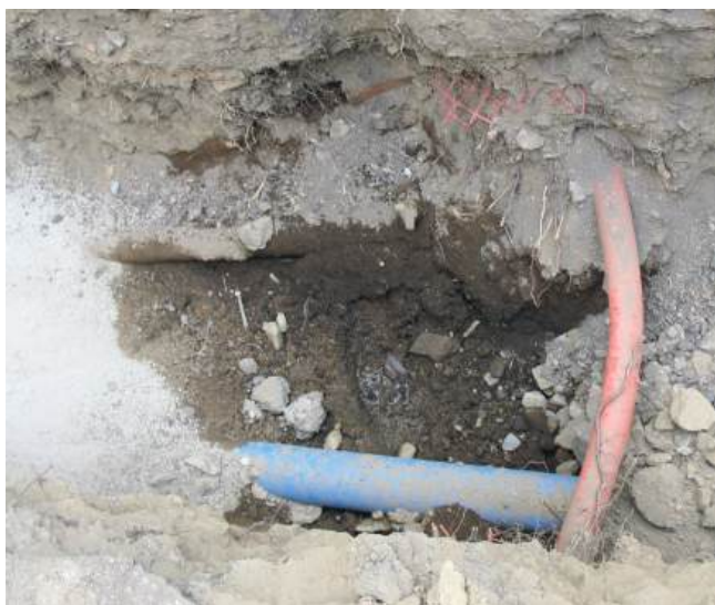
Les travaux ont permis de découvrir une fuite sur la colonne existante qui renforce encore le bienfondé de cette intervention.
